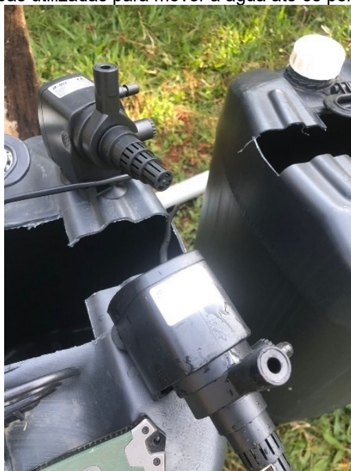
Figura 4 - Bombas utilizadas para mover a água até os perfis hidropônicos.
