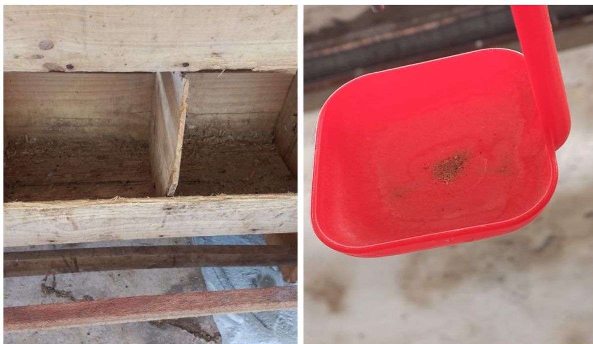
Figura 12 – Não conformidades sanitárias em ninhos manuais de madeira e bebedouros
