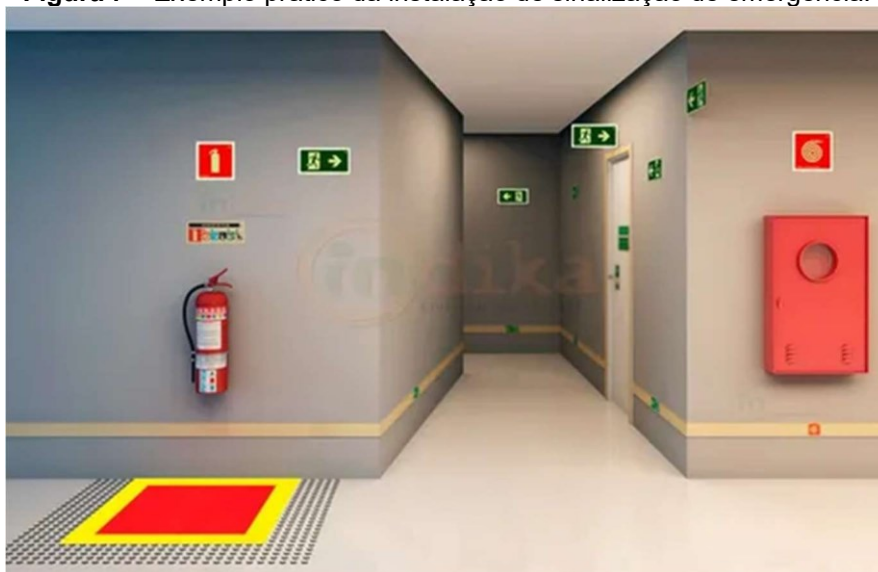
Figura 7 – Exemplo prático da instalação de sinalização de emergência.
