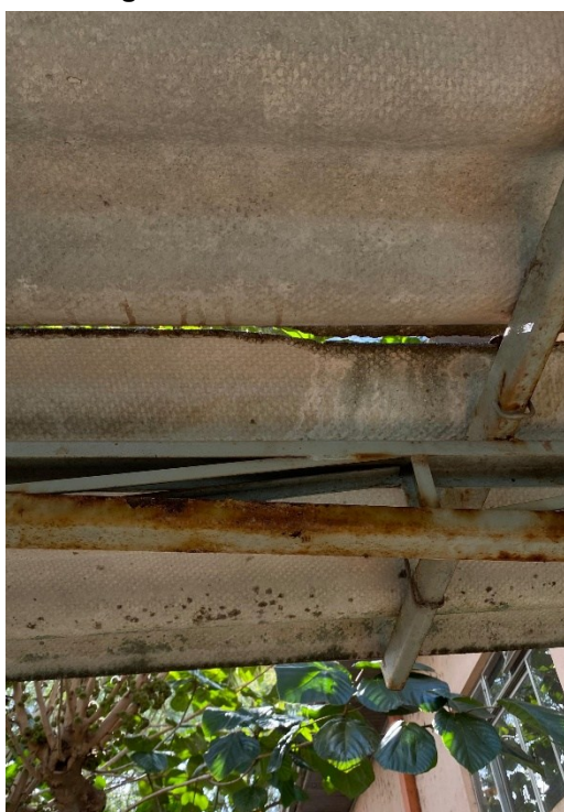
Figura 55 - Danos nas telhas.
