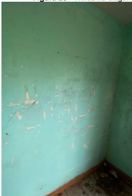
Figura 28 - Trinca na diagonal.
