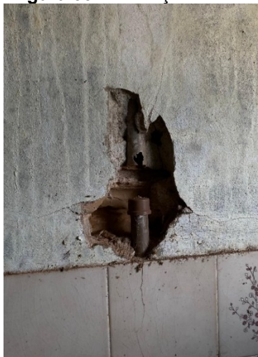
Figura 39 - tubulação a vista.
