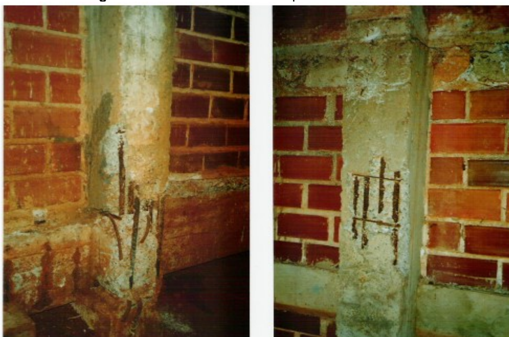
Figura 2 - Corrosão de armadura por falta de cobrimento.
