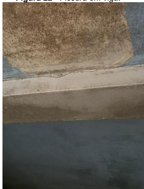
Figura 22 - Fissura em viga.
