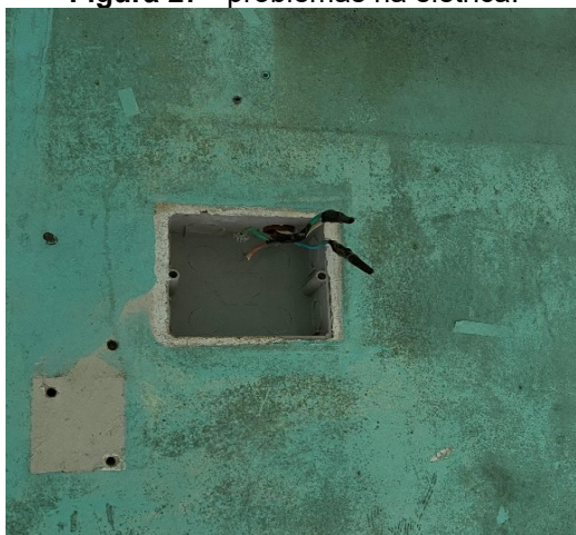
Figura 27 - problemas na elétrica.
