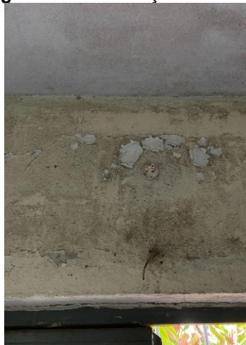
Figura 41 - escamação e fissuras.
