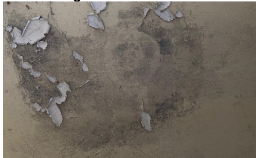
Figura 36 - Danos na tinta.
