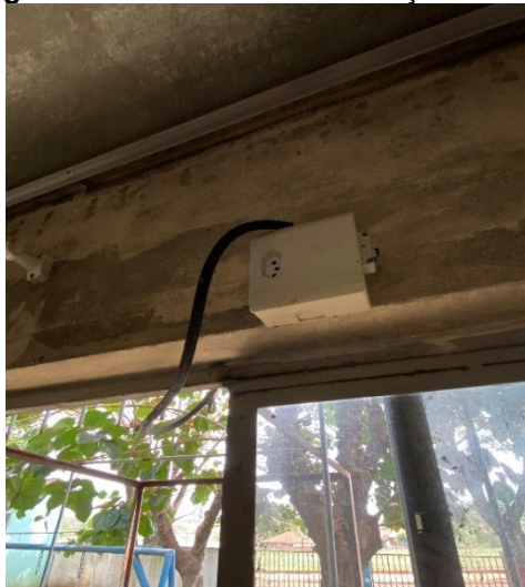
Figura 26 - Problema em instalação elétrica.
