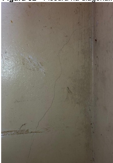
Figura 32 - Fissura na diagonal.
