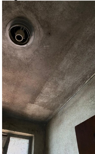
Figura 38 - Mofo no teto.
