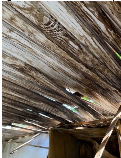
Figura 52 - Cobertura em colapso.
