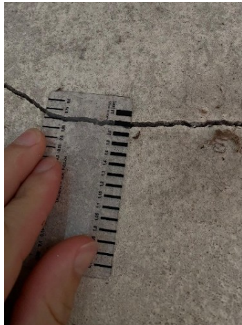
Figura 53 – Rachadura na horizontal.
