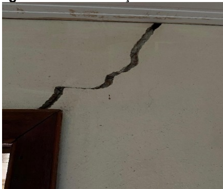
Figura 47 - Continuação da rachadura.
