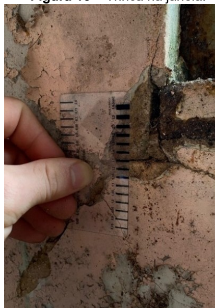
Figura 16 – Trinca na janela.
