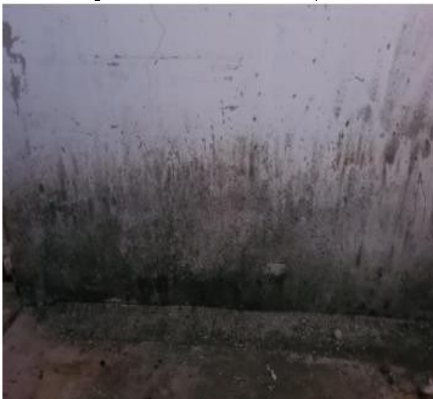
Figura 5 - Manchas de bolor e mofo na parede.
