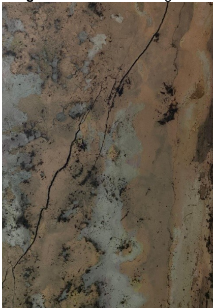
Figura 19 - Trinca na diagonal.
