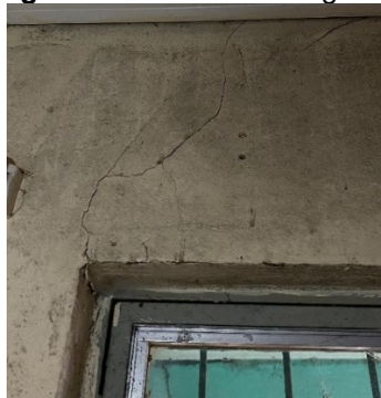
Figura 49 - Trinca na diagonal.
