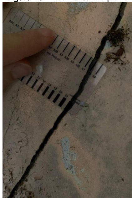
Figura 18 – Rachadura na parede.
