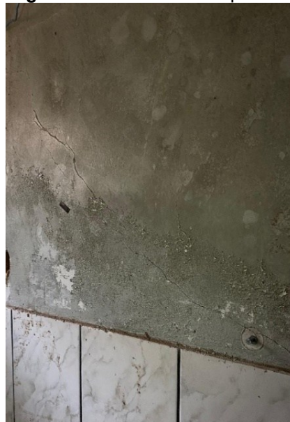
Figura 20 - Rachadura na parede.
