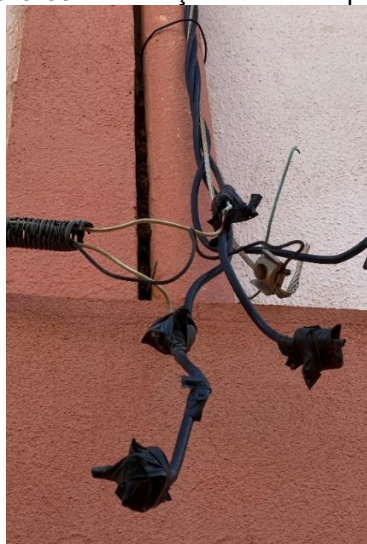
Figura 65 - Instalação elétrica exposta.
