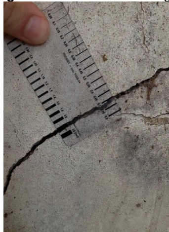
Figura 54 - rachadura na diagonal.
