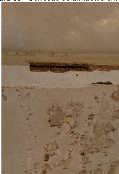
Figura 58 - Corrosão de armadura em viga.
