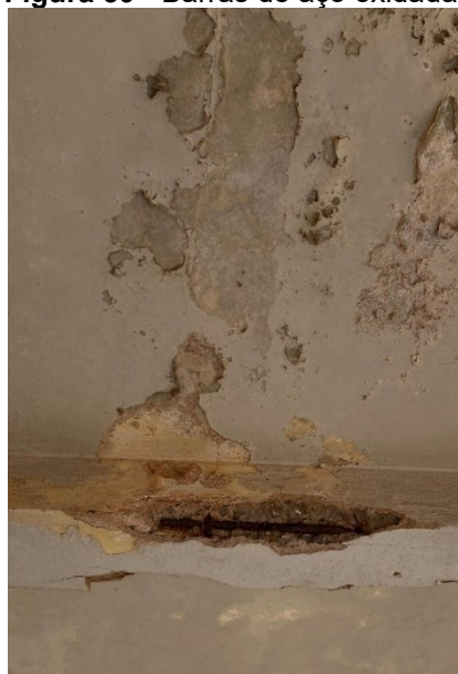
Figura 59 - Barras de aço oxidadas.
