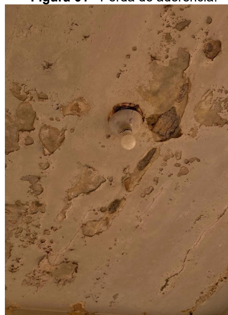
Figura 61 - Perda de aderência.
