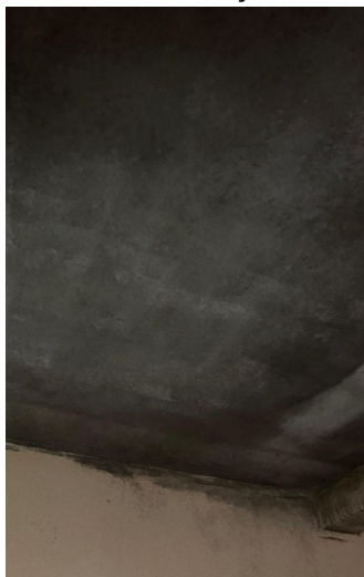
Figura 37 - Concentração de mofo.
