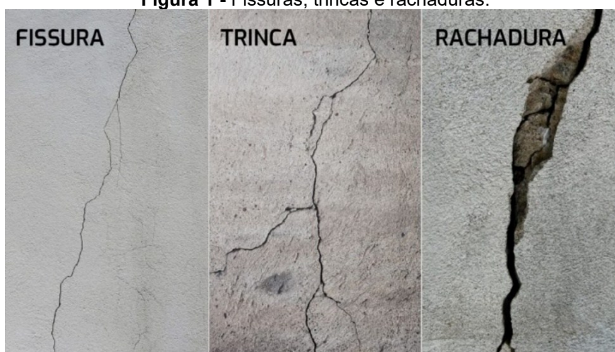
Figura 1 - Fissuras, trincas e rachaduras.
